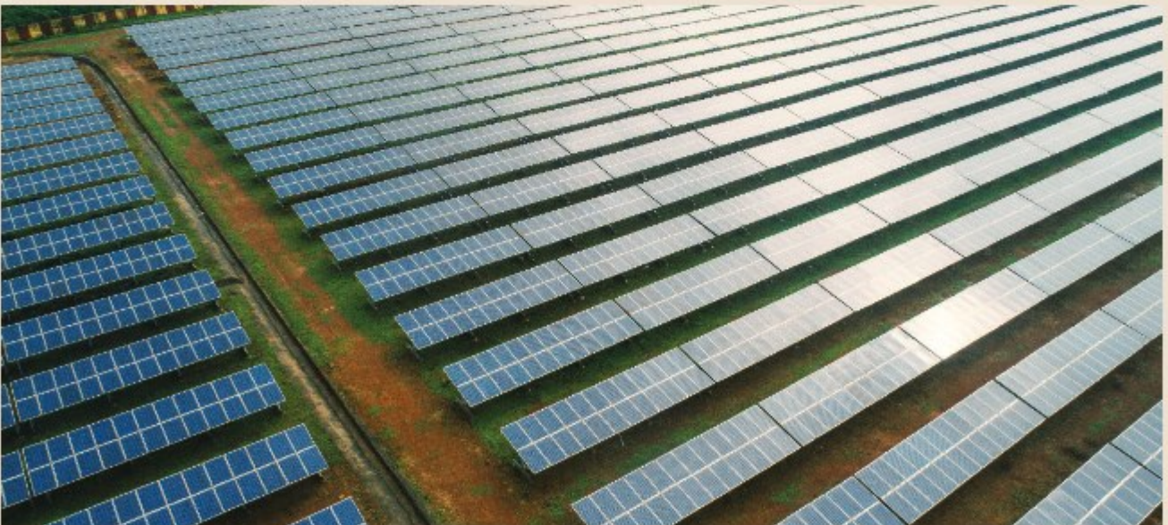
Kapilas Solar Plant, Odisha
